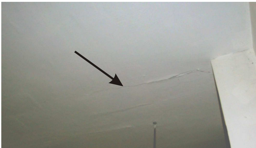
Rys. 6. Widok zarysowań powierzchni dolnej stropu nad garażem pod ścianami międzylokalowymi
